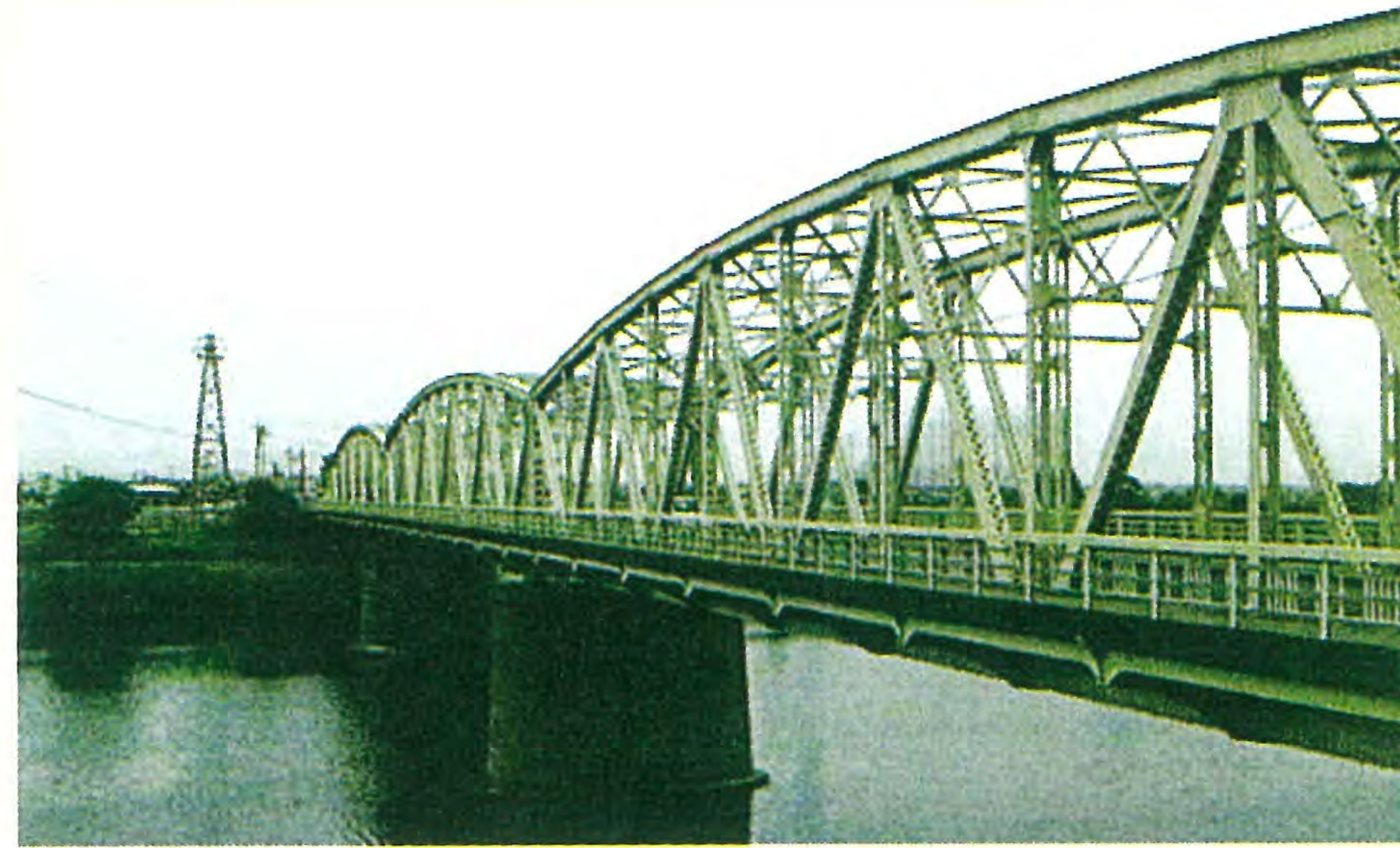
(写真5)旧水府橋(1932(昭和7)年竣工、茨城県水戸市) 〈美しいシルエットの円弧トラス橋。那珂川の改修・大型車交通量の増加のため2013(平成25)年架け替え。橋詰に部材の一部を利用したモニュメントを設置〉
