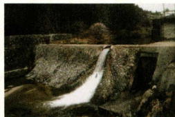
(写真2) 取水堰堤
